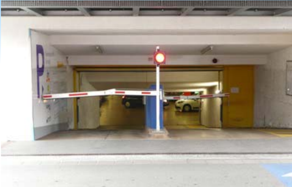
Mit Dauerrot wird die Einfahrt in die Tiefgarage verhindert!
