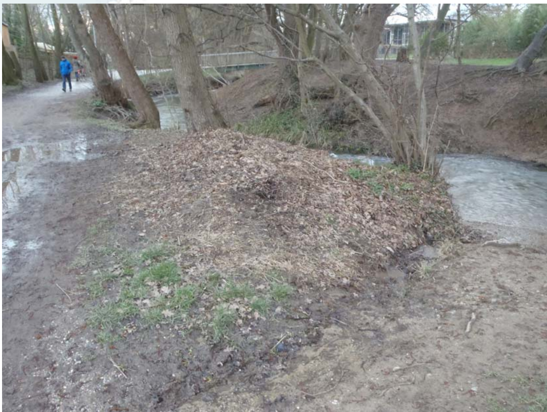
Ein sanierungsbedürftige Stelle kurz vorm Kinderabenteuerhof: die unzureichende Ableitung von zwei Bächen mittels Rohr
