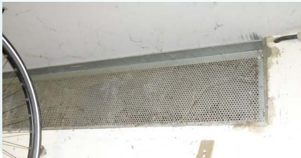
Diesen Lüftungsschacht unter der Kellerdecke bei Gefahr abzudichten dürfte sehr aufwändig sein, zumal er von außen unzugänglich ist Foto: eRich Lutz
