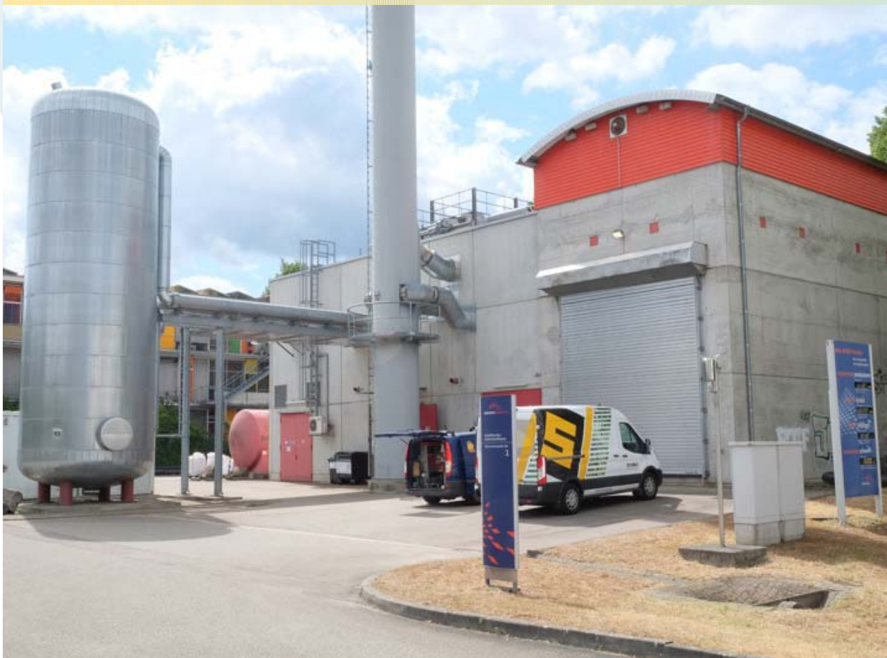
Das Blockheizkraftwerk mit Erdgasspeicher (links) in der Clara-Immerwahr-Straße
